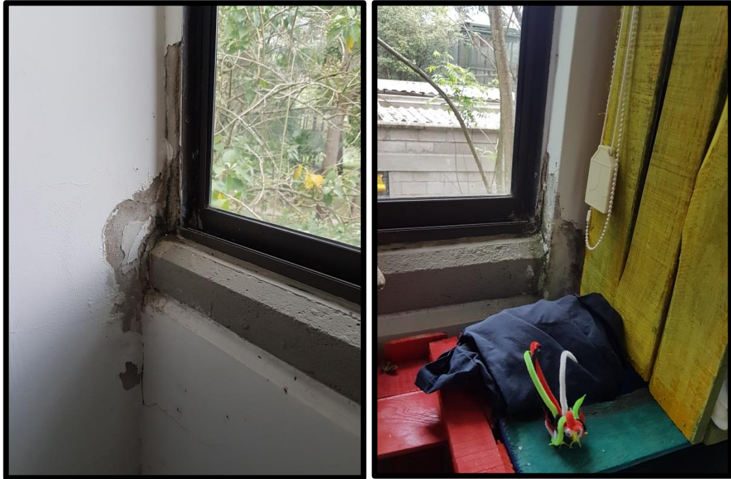
Goteras en las paredes
