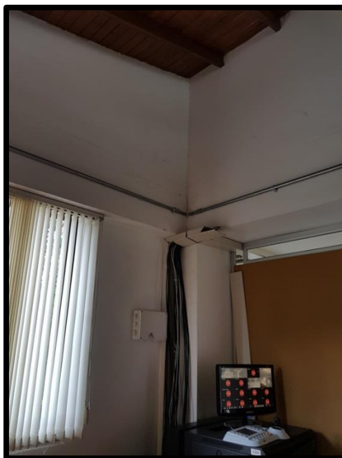
Gotera sobre el sistema de video
